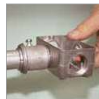
Conduit and connector with the joint sealing prepared to realize the IP54 connection on the multiple box correspondent. Electroducto y conector con las juntas de vedaciones preparadas para realizar la conexión IP54 en la caja multiple correspondiente.
